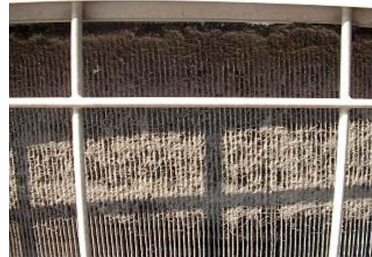
室外機熱交換部の汚れ
