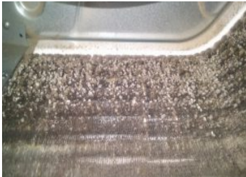
室内機熱交換部の汚れ
